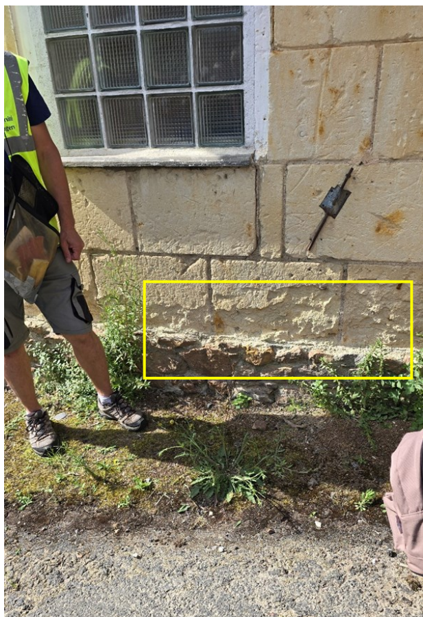
Blocs de tuffeau altéré à la base du mur
