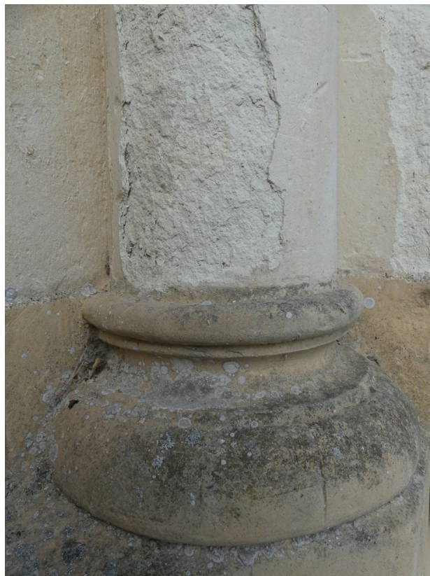
État d'un pilier avant restauration
